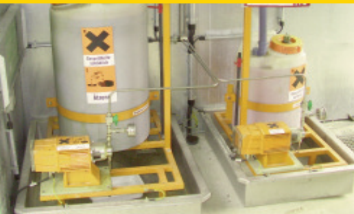
Dosieranlage für Chemikalien und Additive Dosing system for chemicals and additives
