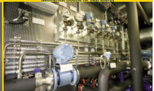
Hochdruckverrohrung und Instrumentierung High pressure piping and instrumentation
