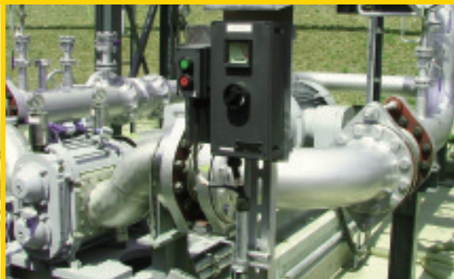
Entladestation für Biodiesel Deloading pump station for biodiesel
