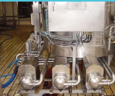
Dosieranlage mit Steuerung Lebensmittelindustrie
