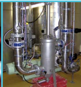
Selbstreinigender beheizter Filter Schokoladeproduktion
